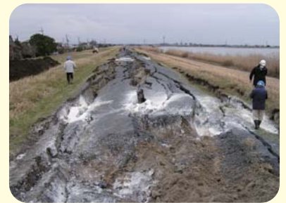
東日本大震災の被災状況調査
