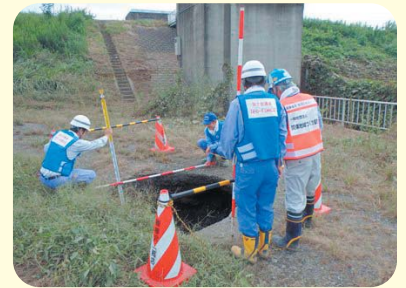
関東・東北豪雨災害の鬼怒川被災状況調査
